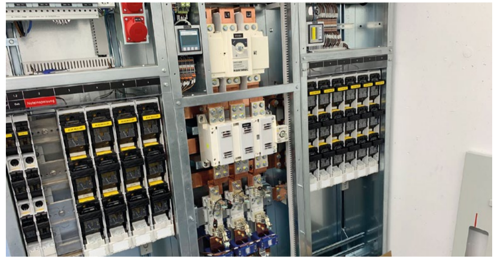
Viele Schalter und Hebel: der Niederspannungsverteiler hat eine zentrale Funktion im elektrischen Netz. In ihm sind verschiedene Sicherheits- und Schaltelemente zur Verteilung von Strom untergebracht.
