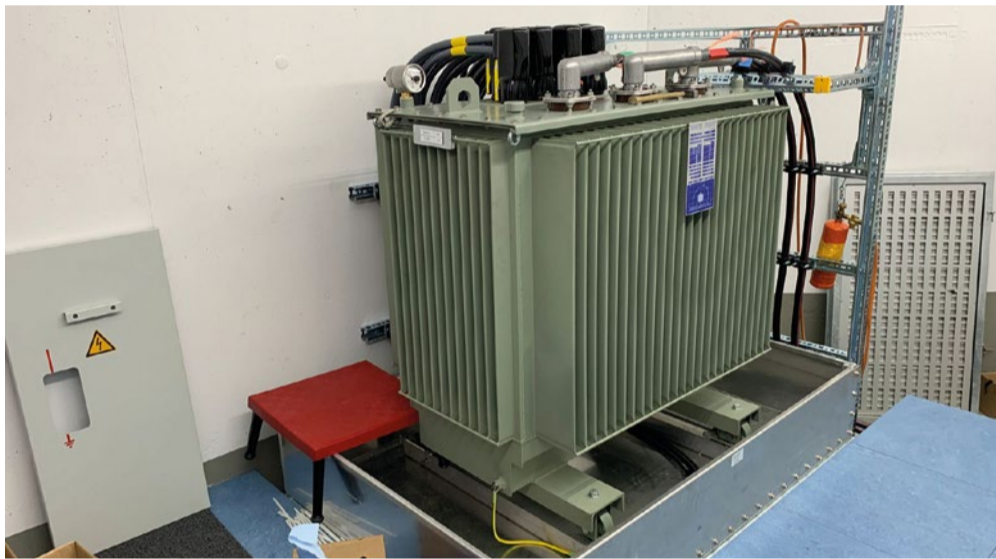
Der Trafo – Namensgeber des Traforaums. Er dient der Spannungsumwandlung und ermöglicht die Verteilung von Strom durch den Niederspannungsverteiler. Fotos: GV
