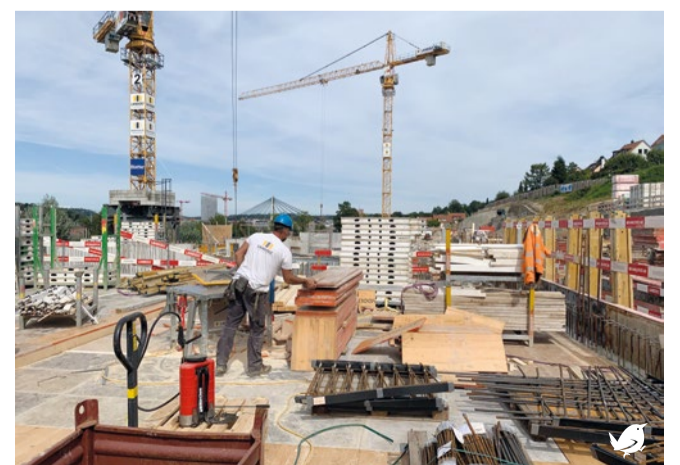
Die Holzschalung für die Tiefgaragendecke wird in Handarbeit erstellt. Sie muss stabil und dicht sein, denn darüber wird zuerst die Eisenbewehrung verlegt und danach der Beton gegossen. Foto: GV
