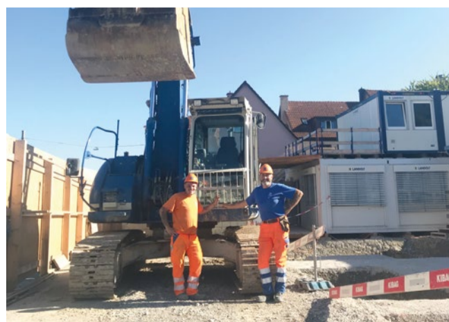
Freitag, 13. September: Der viel besagte «Unglücksfreitag» wurde für diese Bauleute zum Glückstag. Dann nämlich haben sie den Aushub erfolgreich abgeschlossen – und wurde der letzte Bagger abgeholt. Foto: MS
