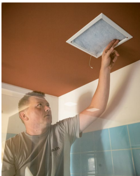
In den Nasszellen wird die feuchte Abluft via Steigzone übers Dach abgesaugt.
