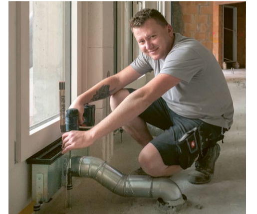
Im Siedlungslokal wird die frische Luft unterhalb der Fensterfronten angesaugt.
