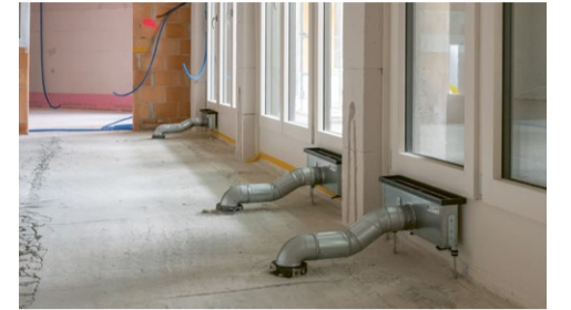
Im Siedlungslokal sorgt eine kontrollierte Lüftungsanlage für angenehmes Raumklima. Das ist ökologischer, als wenn im Winter das Fenster immer wieder geöffnet wird.
