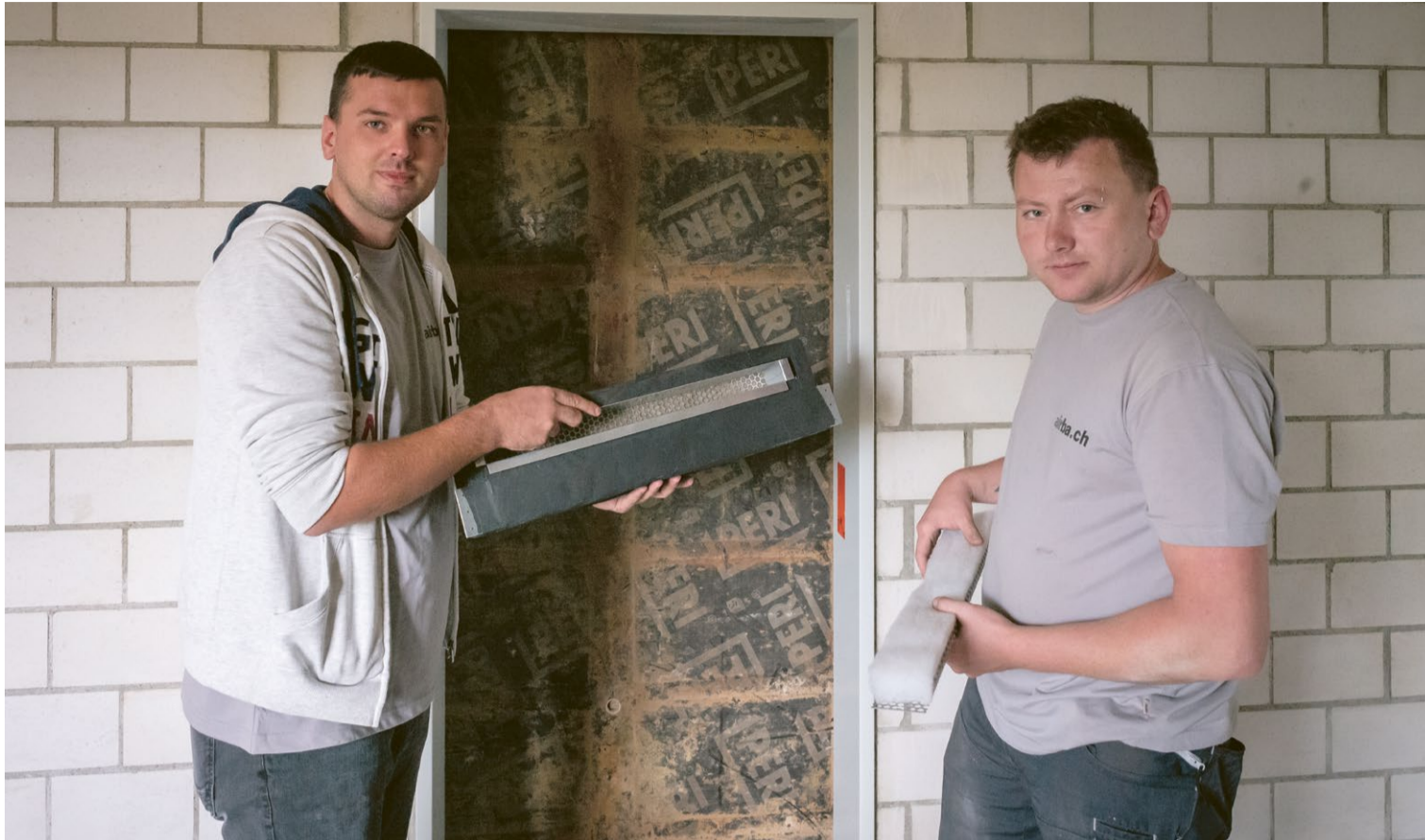
Projektleiter Emir Krasniqi (links) und Monteur Tomasz Bunsch bereiten die Montage eines ALD-Elementes vor. Bilder: PB
