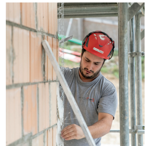
Ein korrosionsgeschütztes Metallprofil schützt die Ecken.
