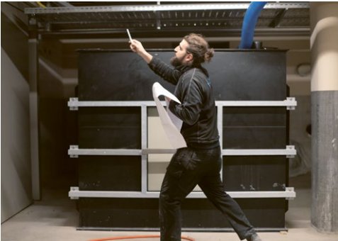
Devis Aloia, Projektleiter der Fiorentino Haustechnik GmbH, zeigt, wohin das Wasser aus dem Tank hinfliesst.
